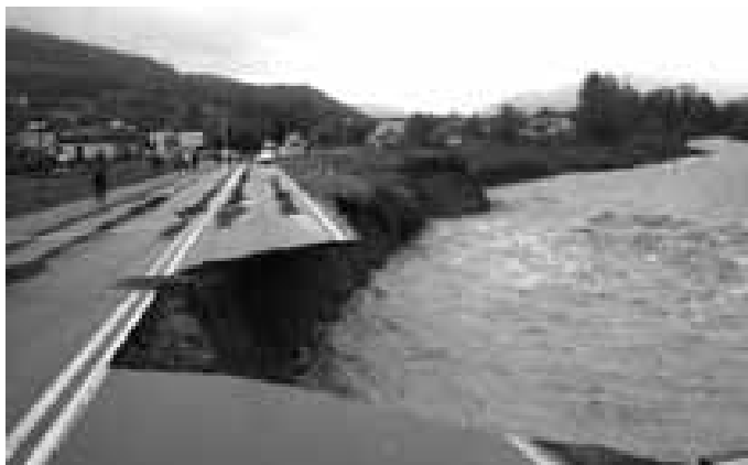
Uszkodzony most na drodze wojewódzkiej w Kamienicy Dolnej - rwąca woda podmyła przyczółki, a w efekcie oberwała się część asfaltu
